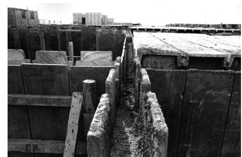
Wall/roof joint cast on site. Note upper ends of panels shaped to receive roof components. Re-bars and concrete will be placed in space between wall panels to form tie-beam. Unión pared-techo fundida in situ. Nótese los extremos superiores de los paneles conformados para recibir los componentes del techo. En el espacio entre los paneles de pared se pondrán barras de refuerzo y se verterá hormigón para formar la viga de amarre.
