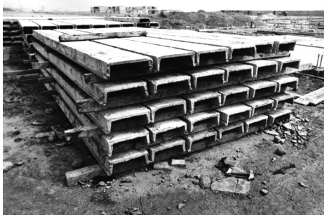
Roof components stacked ready for use. Componentes de techo apilados, listos para su uso.
