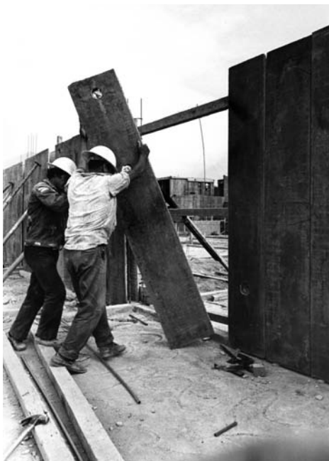
Erection of wall components. Note ease of handling. Montaje de componentes de pared. Nótese la facilidad de manejo.
